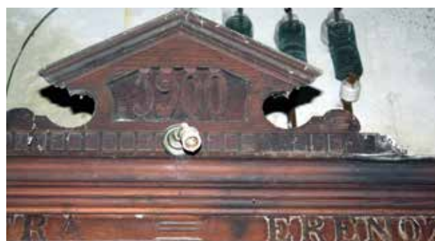
Ereñotzuko Zentral hidroelektrikoaren barrualdea, kontrol-kaxa duen armairuaren xehetasunarekin.
